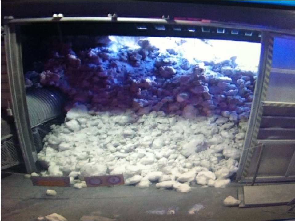
Nach dem Abgang einer Gleitschneelawine am frühen Morgen des 14.03. wurde ein Stolleneingang auf der Baustelle der Kraftwerke Linth-Limmern verschüttet. Es gab keine Schäden (Limmerentobel, Glarus Süd) (Foto: R. Stüssi, 14.03.2012).
