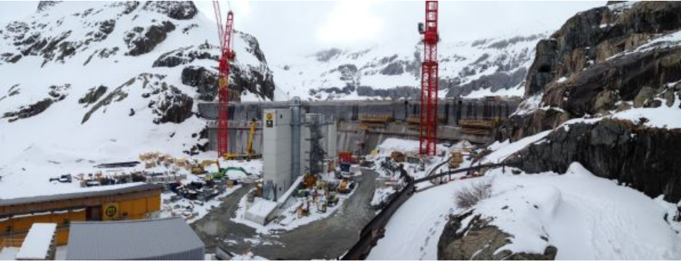
Travaux difficiles à cause de la neige au chantier du projet Nant de Drance (Trient, VS). Sur le site du vieux Emosson à 2180 m une nouvelle prise d'eau est construite (photo: J.-L. Lugon, 25.05.2013).
