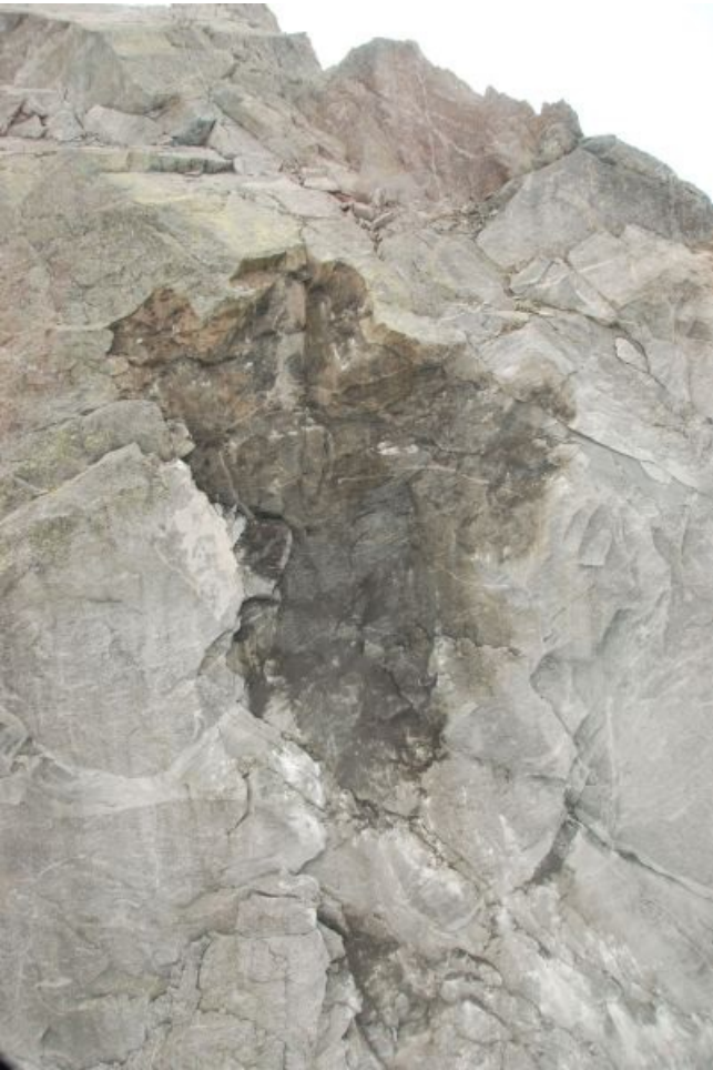
Kleiner Felssturz an der Punta Trubinasca (2998 m, NE, Bergell, GR) am Freitag, 26.07.2013. Die Anrissfläche war nass. Ob Eis vorhanden war, konnte aus der Luft nicht festgestellt werden (Foto: SLF / M. Phillips).
